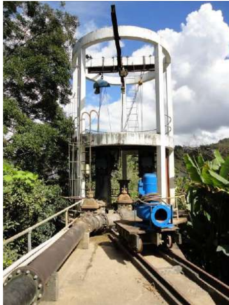
Figura 7: Elevatória de Água Bruta. Fonte: STE, 2010
