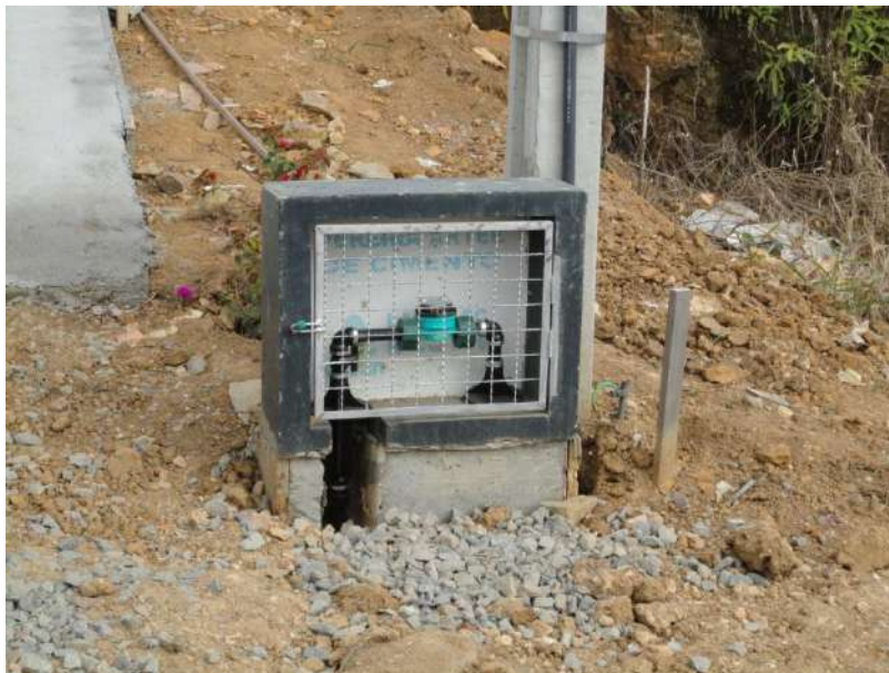
Figura 23: Micro-medidor residencial com Hidrômetro – rede de abastecimento. Fonte: STE, 2010
