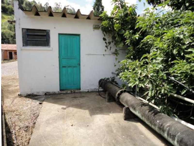
Figura 8: Adutora de água bruta. Fonte: STE, 2010
