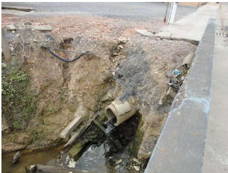
Figura 47: Lançamento de Esgoto em rede de drenagem pluvial. Fonte: STE, 2010
