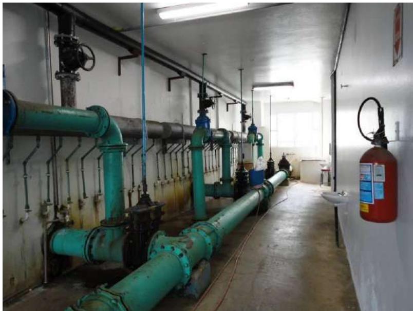
Figura 14: Casa de lavagem dos filtros. Fonte: STE, 2010
