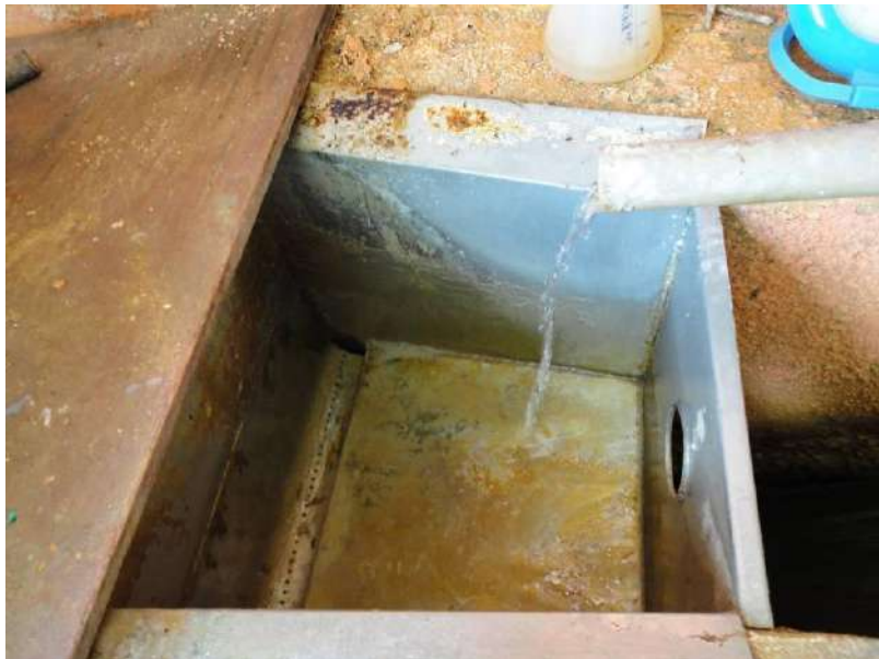
Figura 12: Desinfecção com cloro e fluoretação em Tanque de contato. Fonte: STE, 2010
