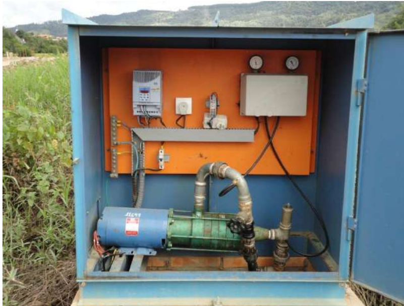
Figura 22: Booster da Casan. Fonte: STE, 2010
