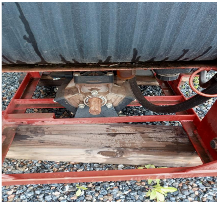
Local do implemento onde estaria faltando um mangote
